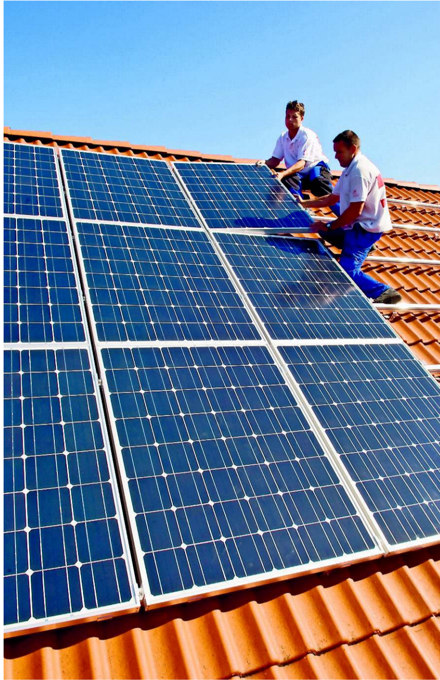
Auf grossen Dächern lohnt sich die Montage von Solarzellen. KEYSTONE
